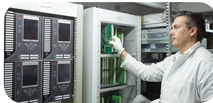
PROTECTIONS, CONTRÔLE COMMANDE ET AUTOMATISMES
